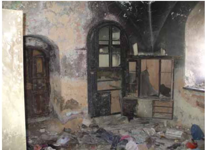
صورة توضح خزائن خشبية تالفة
