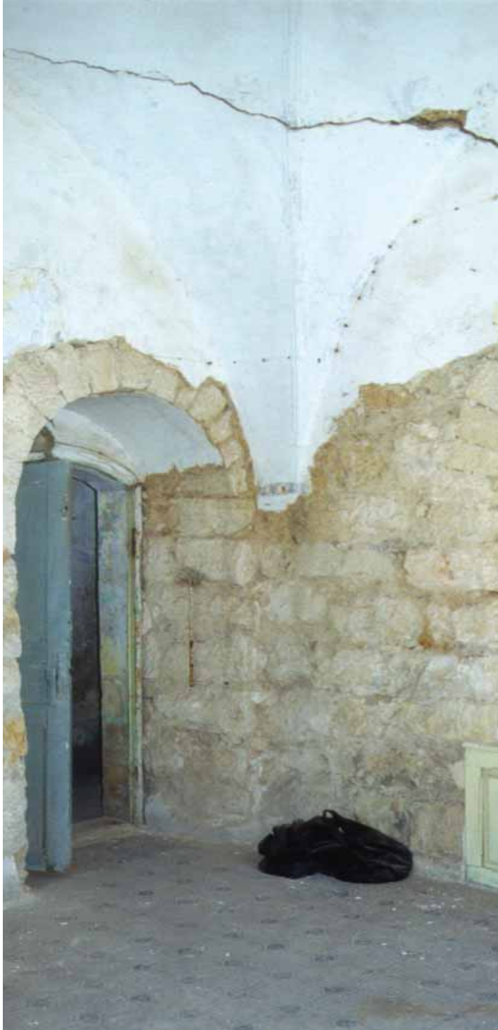
صورة توضح هبوط الاكثاف في احد المباني
