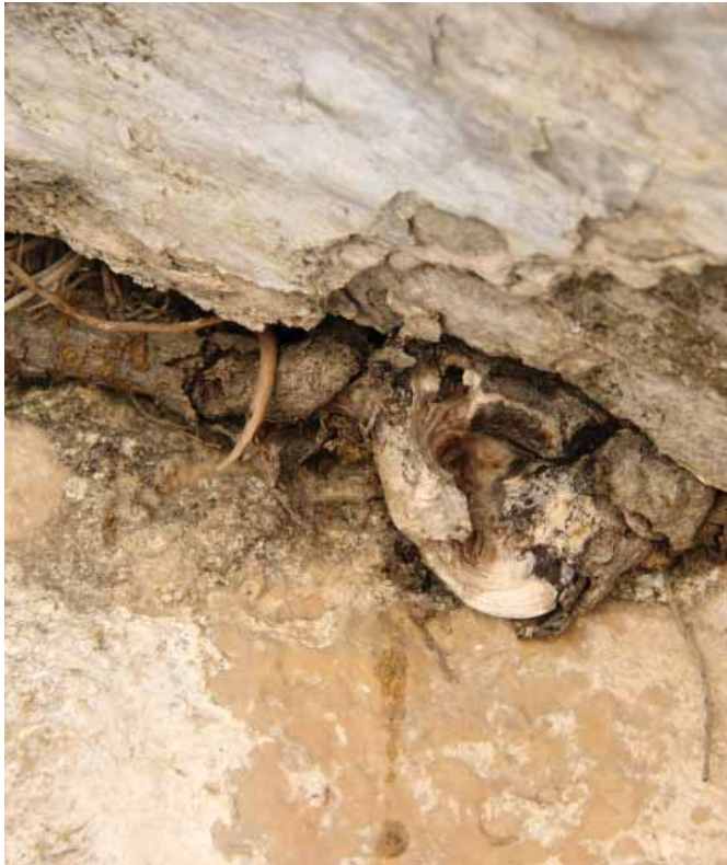
صورة توضح نمو جذر شجرة بين طبقات البناء
