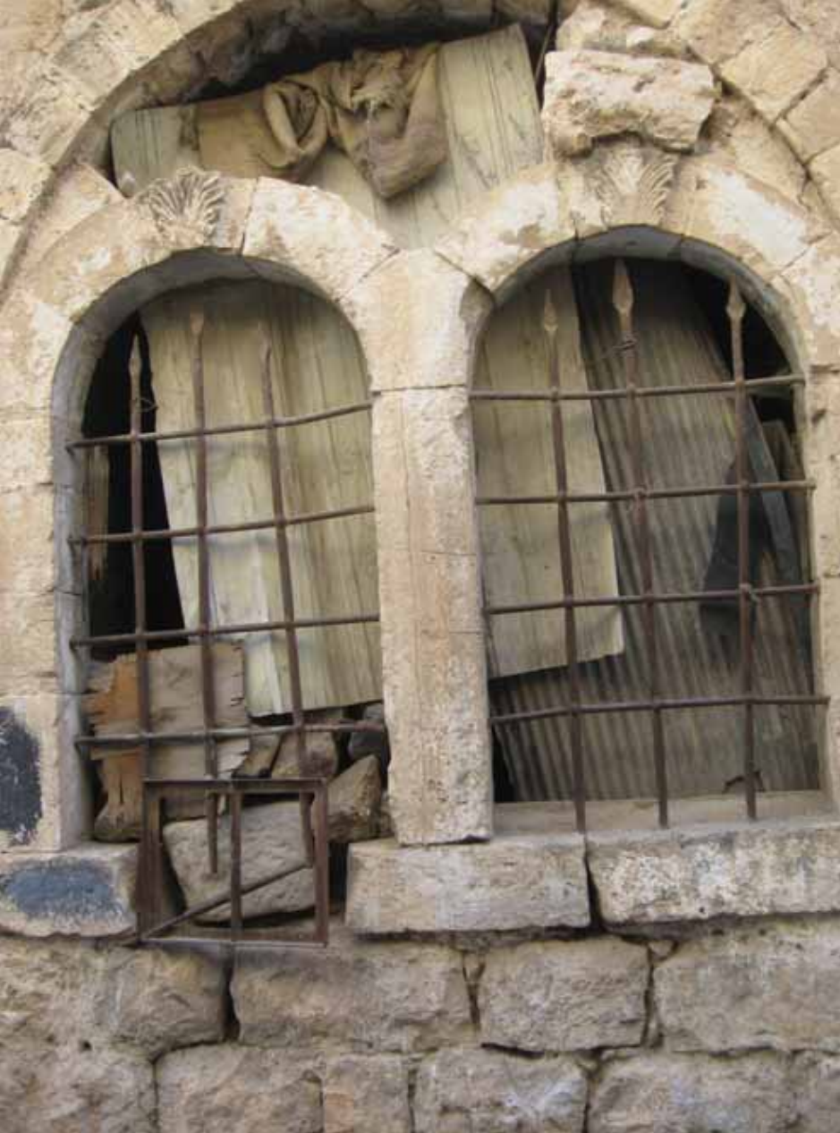
صورة توضح تكسر عتبات الشباك بسبب الحماليات الحديدية
