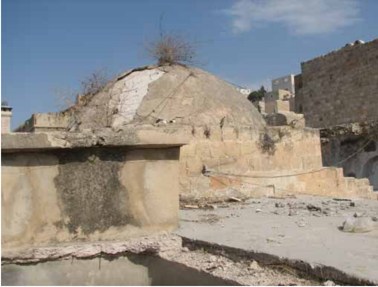
صور توضح مشكلة التشقق في القباب في البلدة القديمة
