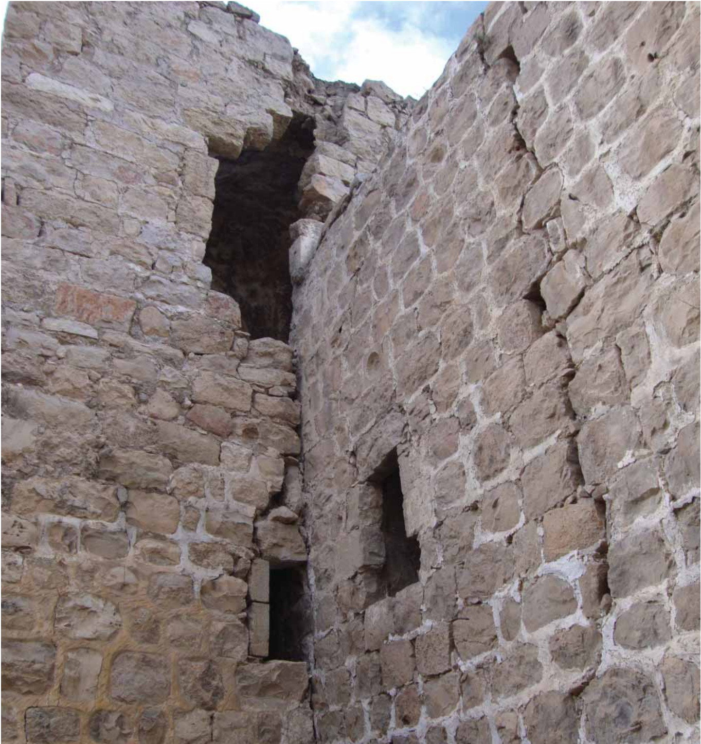
صور توضح تأثير هبوط الاساسات على المباني القديمة
